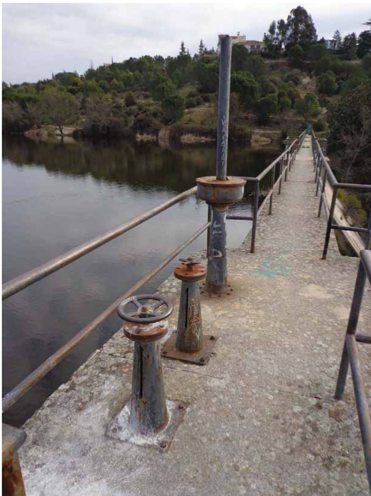
Fotografía nº 9. Válvulas de desagüe y toma de agua, en zona coronación.
