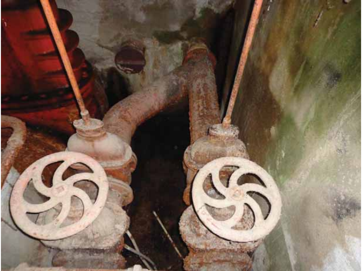
Fotografía nº 15. Válvulas de toma de agua en caseta de válvulas.
