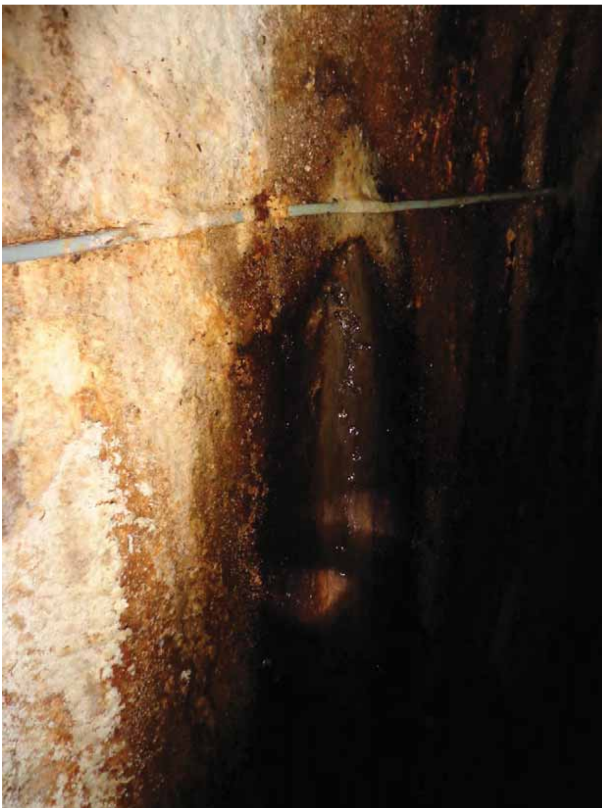
Fotografía nº 13. Detalle de filtraciones de agua en la galería de inspección.
