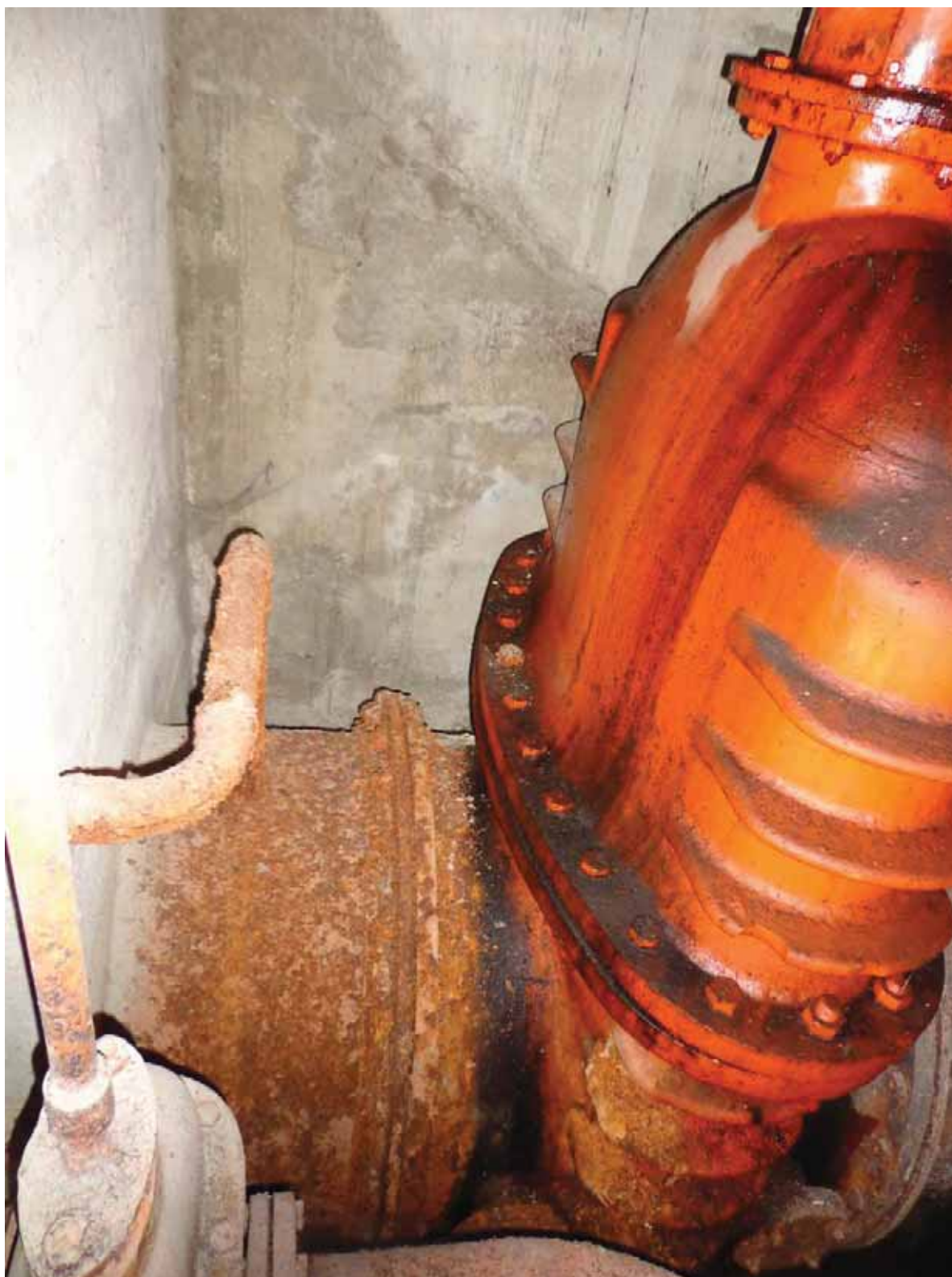
Fotografía nº 16. Válvula de desagüe de fondo, en caseta de válvulas.
